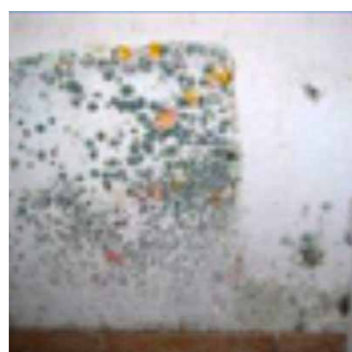
Contaminations fongiques sur un mur
