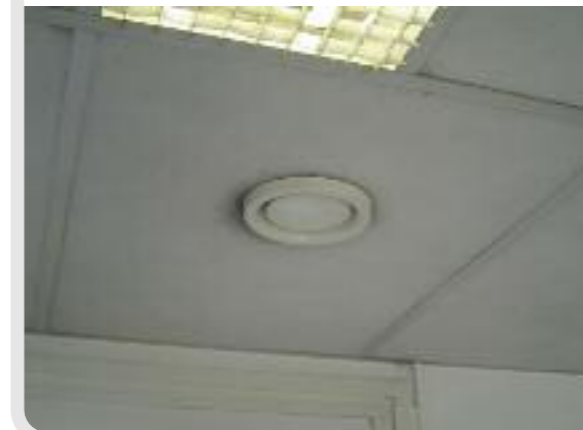
Photo 10 : Bouche de soufflage d'air dans une cantine
