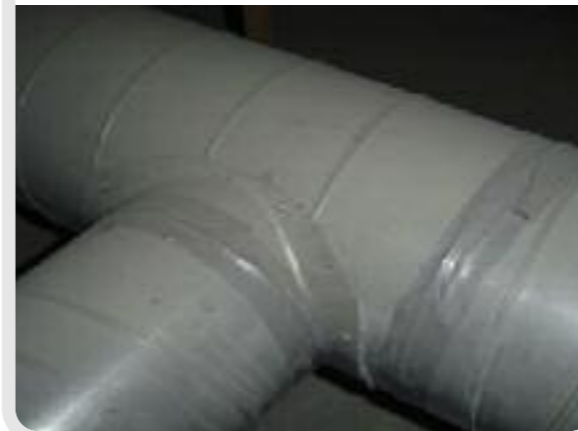
Photo 5 : Conduits étanches en combles
