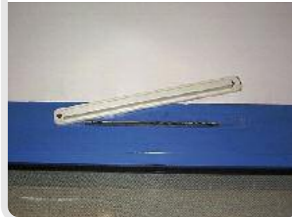
Photo 7 : Entrée d'air avec réservation trop étroite
