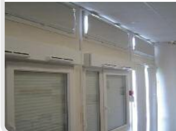
Photo 9 : Entrées d'air dans un dortoir
