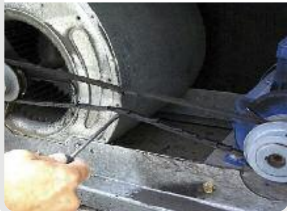
Photo 3 : Courroie ventilateur en mauvais état
