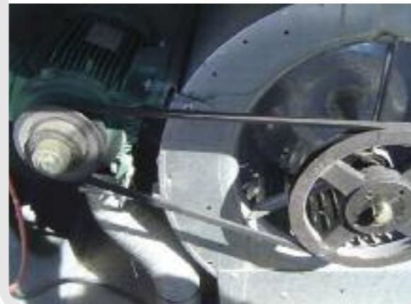
Photo 2 : Courroie ventilateur en bon état
