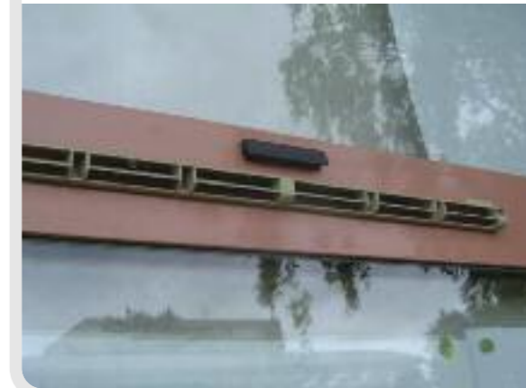
Photo 8 : Entrée d'air dans une fenêtre
