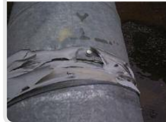
Photo 6 : Adhésifs détériorés sur conduits extérieurs
