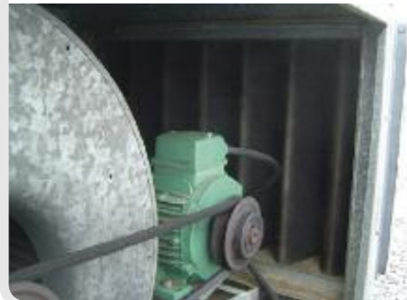
Photo 4 : Intérieur CTA avec filtre à air
